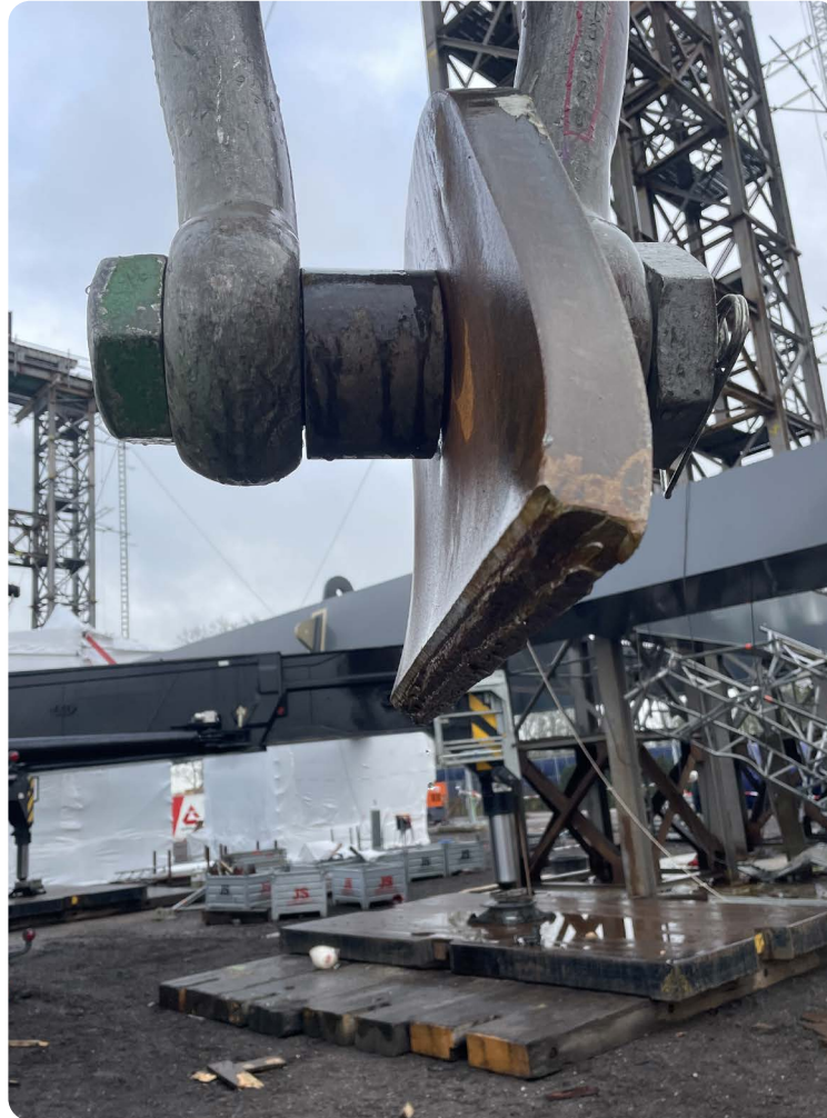
Figuur 16: Restant van hijssoog van de boogtop, links van het hijssoog is de geplaatste bus in de harpsluiting zichtbaar (bron: Nederlandse Arbeidsinspectie).
