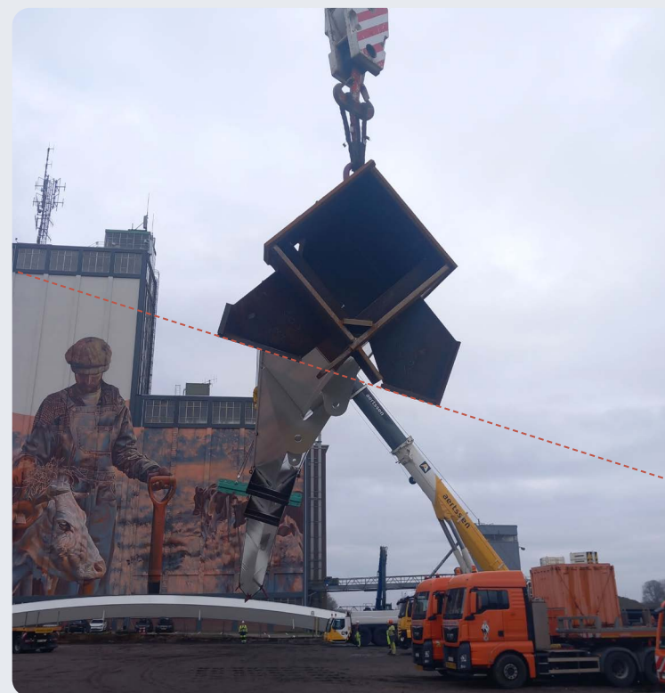
Figuur 30: Foto van scheef hangend boogbeen (bron: staalbouwer, bewerkt door de Onderzoeksraad voor Veiligheid).
