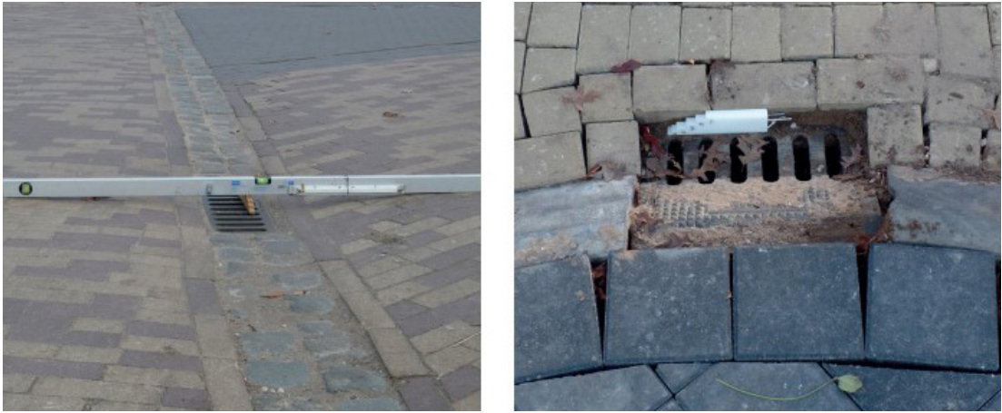
Afb. 14 Goten: gevallen van (mol)goten met te diep liggende kolken en gootlagen
